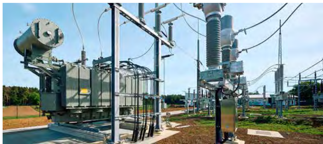
Zum Vergleich: die großen Transformatoren im Umspannwerk Zimmern ob Rottweil
