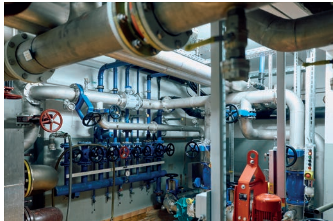
Das neue Gebäude für die Prozesswasserbehandlung (o. r.) beheimatet eine ganze Reihe moderner Technik (u. l.).
