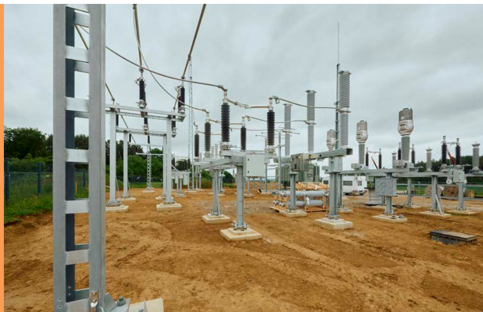
Ein Teil der 110-kV-Freiluftanlage des Umspannwerks in Zimmern
