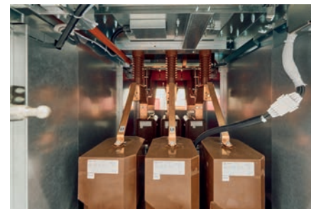
Der Kabelanschlussraum der Schaltanlage mit Strom- und Spannungswandlern.
