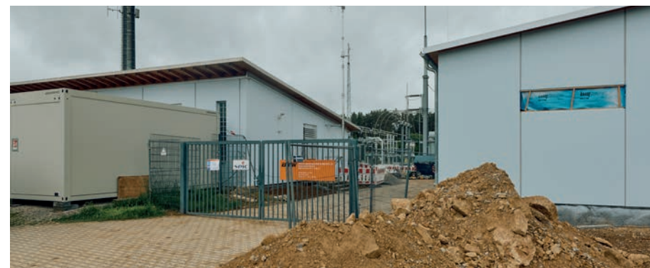
Das neue Betriebsgebäude (r.) mit der Schaltanlage ist bereits fertiggestellt. Eine Längskupplungsverbindung zum alten Gebäude (l.) ermöglicht zukünftig die Zusammenführung beider 20-kV-Anlagen.
